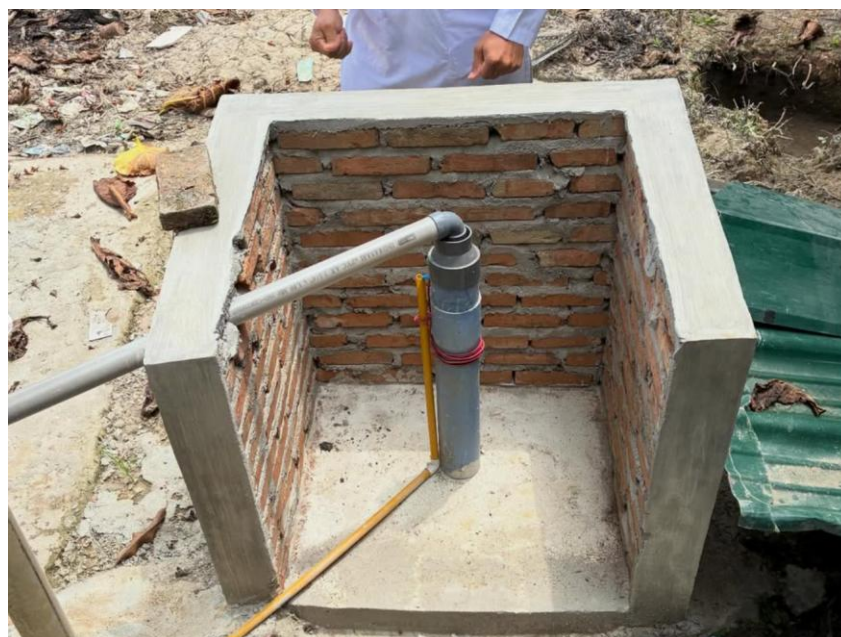
Gambar 2. Lokasi Titik Pompa Air
